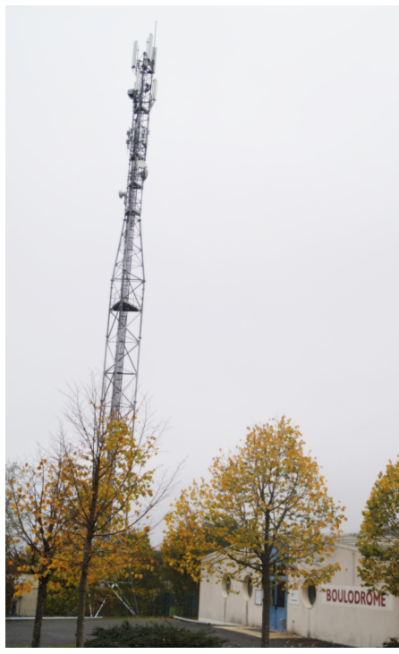
L'une des antennes-relais à St-Pierre-Montlimart.
